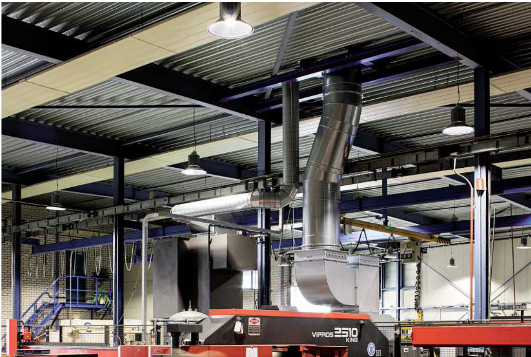
◀ An klassischen Industrie- arbeitsplätzen, an denen das Licht aus größeren Höhen kommt, werden Hallentief- strahler der Marke Ledayo eingesetzt, die effizienter und langlebiger als Leuchten mit herkömmlicher Lichttechnik sind.
